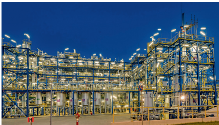
Lichtblick Chloressigsäure-Anlage von PCC in Polen
