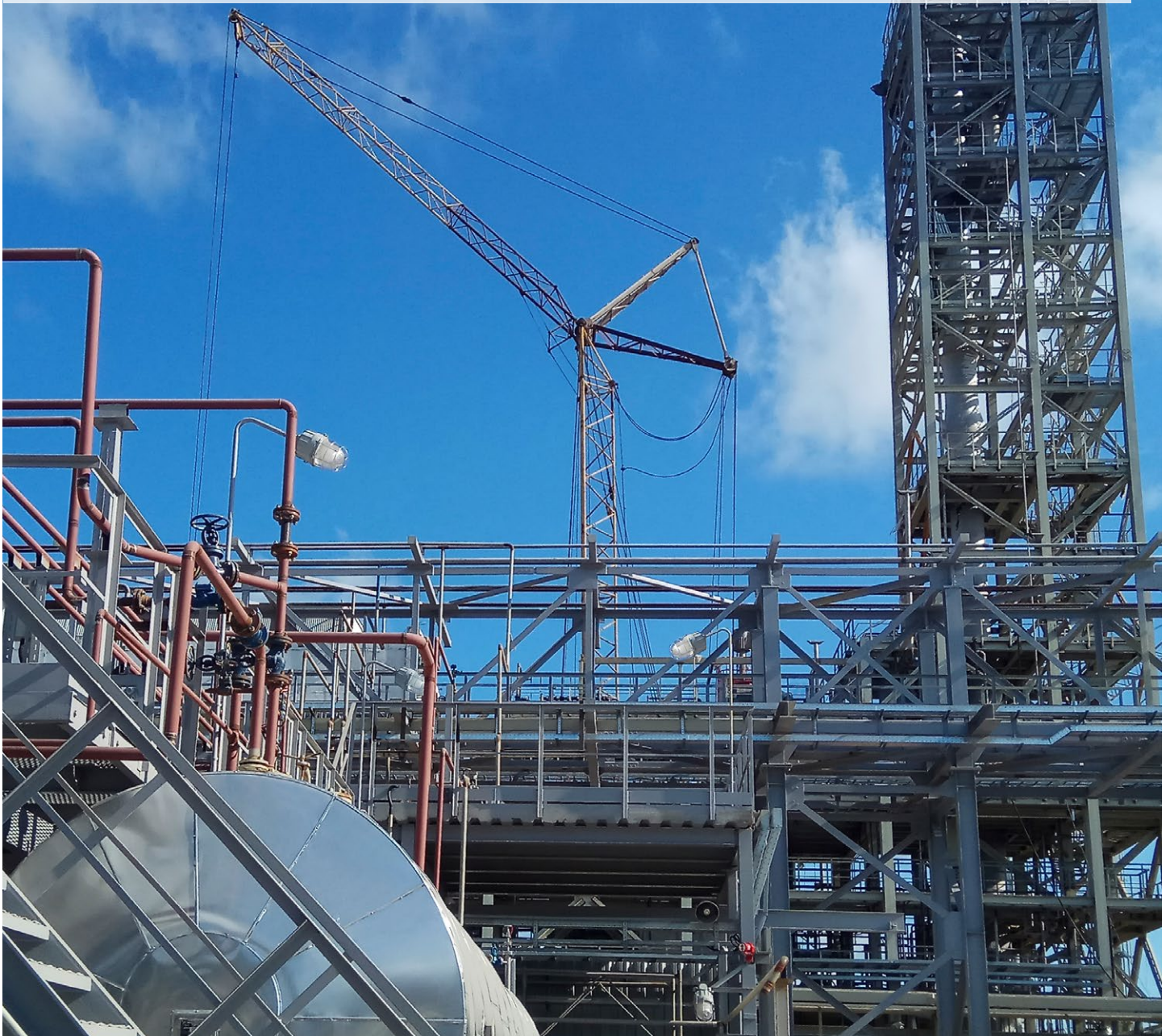
Die Produktionsanlage für hochreinen Dimethylether (DME) in Aerosol-Qualität unseres russischen Joint-Ventures DME Aerosol, Pervomaysky, im August 2018: Die Anlage soll im Herbst 2018 an den Start gehen. Rechts im Bild ist die rund 45 Meter hohe Destillationskolonne zu sehen.
